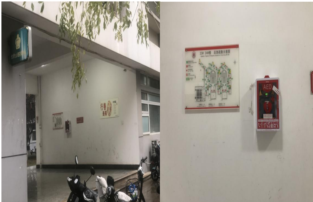
8. 23号楼（一楼中间过道西侧墙）：
